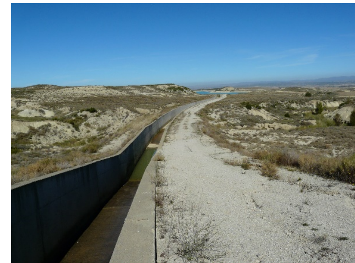
Vista general del canal antiguo de alimentación del embalse de Laverné y de la prevista zona de ensayos
